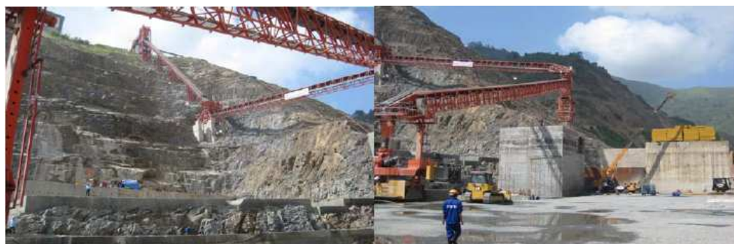
Hình 3: Thi công hệ thống móng băng tải vận chuyển bê tông RCC
