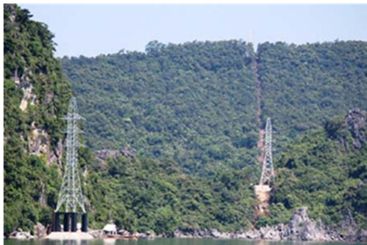
Hình 4: Tuyến đường dây 110kV đảo Cô Tô chạy dọc theo chân núi
