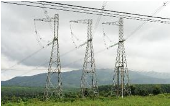
Đường dây 500KV Pleiku – Phú Lâm
