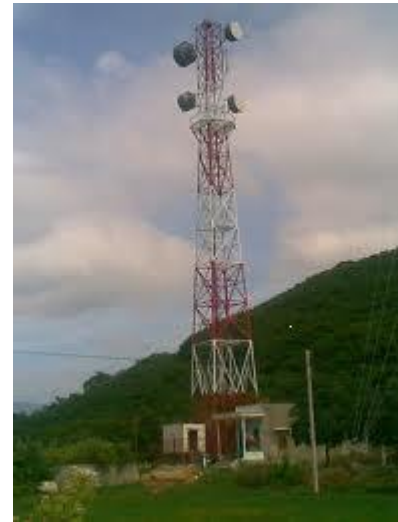
Trạm viễn thông Vietnam Mobile
