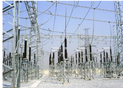
Trạm biến áp 220 KV Krong Buk
